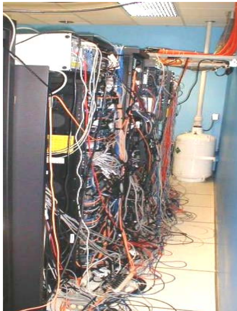
图3 — 紊乱缆线的例子
